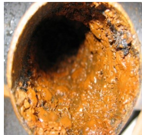
Rohrleitung mit Korrosionen
